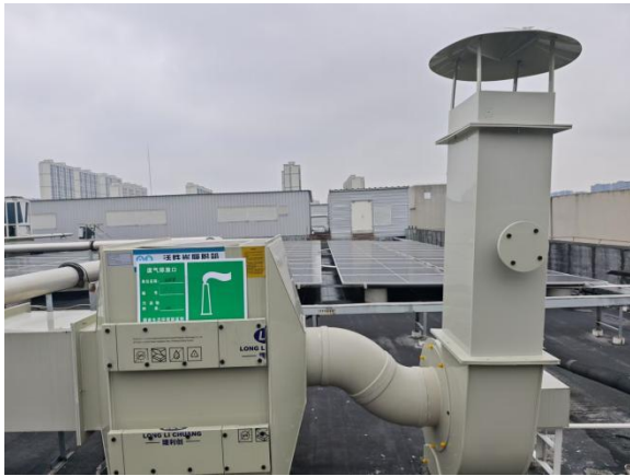
废气排放口标牌 (DA002)
