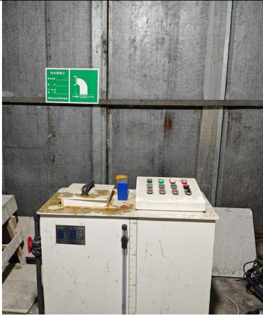
废水排放口标牌
