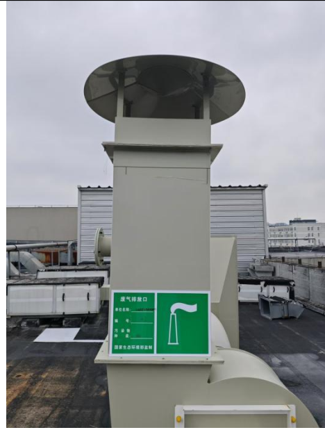
废气排放口标牌 (DA001)
