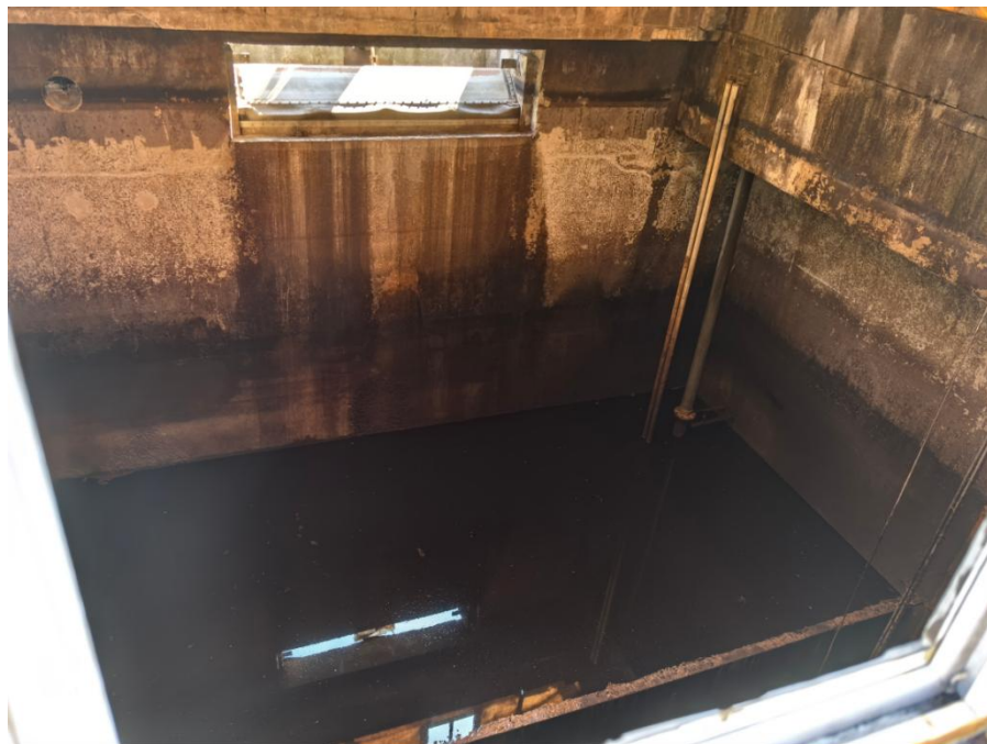
污水站事故应急池
